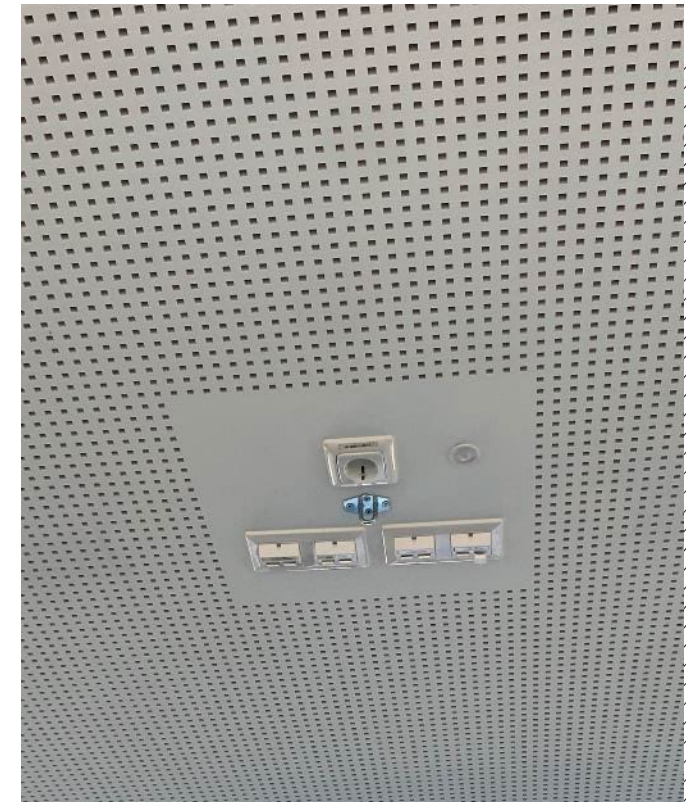
Flexibilität – auch Strom und Netzwerk von der Decke
